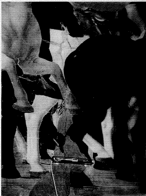
Fig. 25b - Estensimetro provvisto di trasduttore elettrico installato su una lesione presente nell'abside della Chiesa di S. Francesco di Arezzo.
